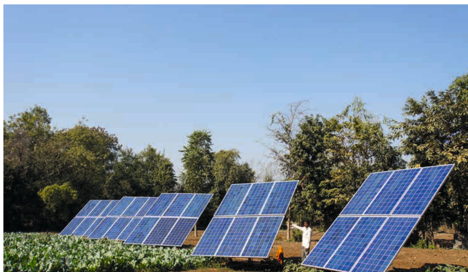
Solarpanel in Indien
