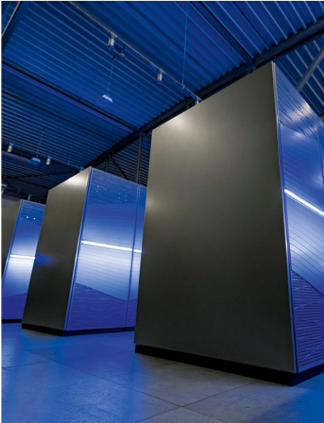
Das erste Modul von JUWELS in der Rechnerhalle des JSC
