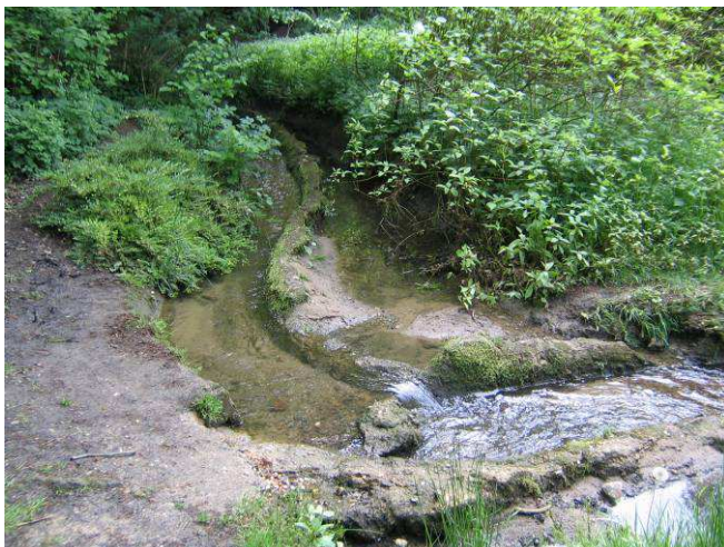
Ausgespülter Beton am Regenwasserzulauf
