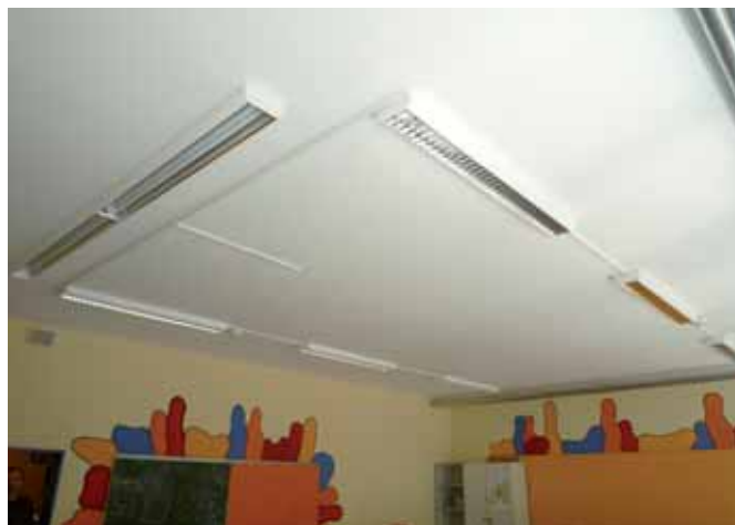
Deckenbeleuchtung in einem Klassenraum der Realschule
