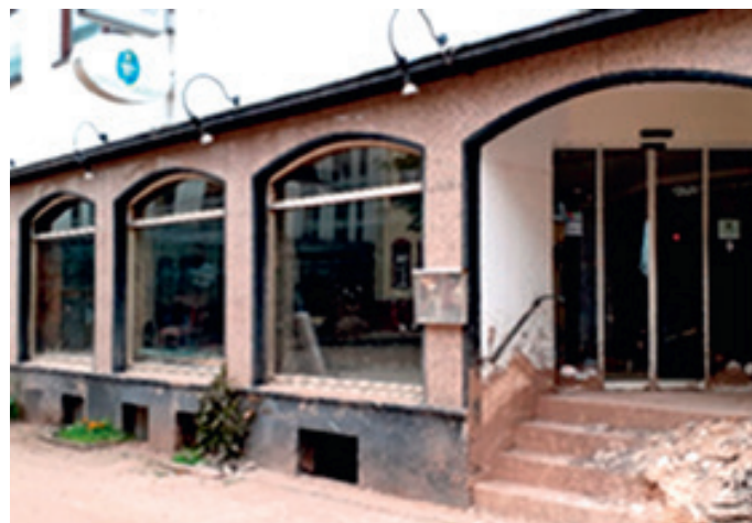
Das durch die Flutkatastrophe zerstörte Café im September 2021. (© Klaus Stüber)
