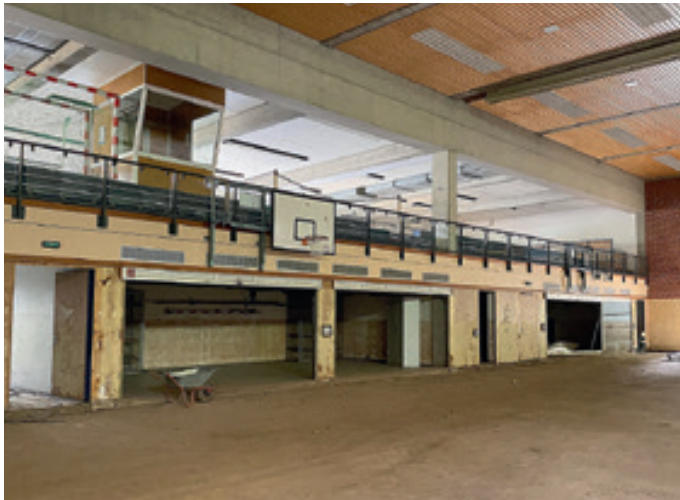
Geräteraumtore, Boden und Prallschutz wurden durch das Hochwasser komplett zerstört.
