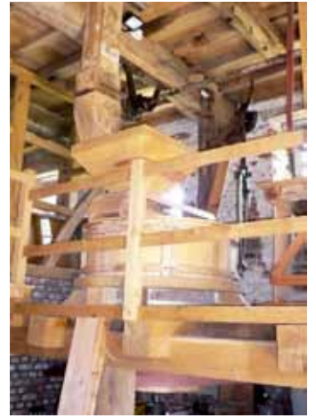
Baalsbrugger Mühle, restaur. Mahlwerk
