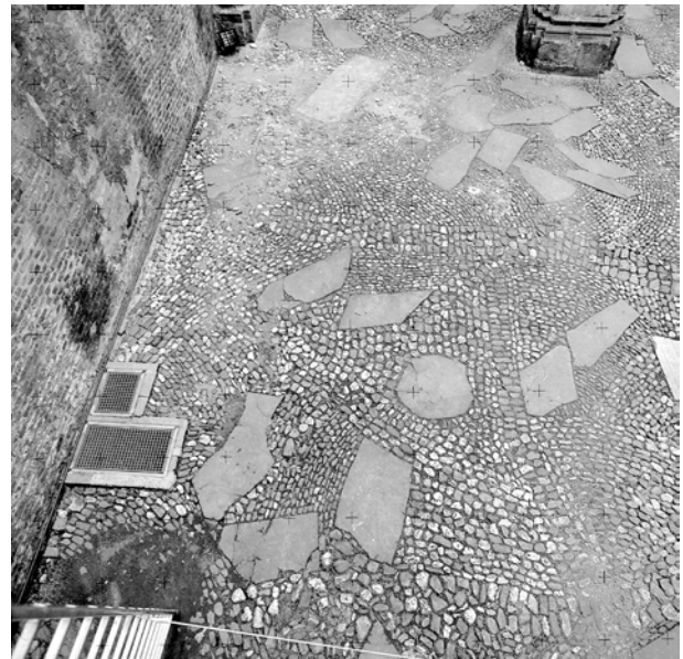
Fußboden in Schrägaufnahme.
