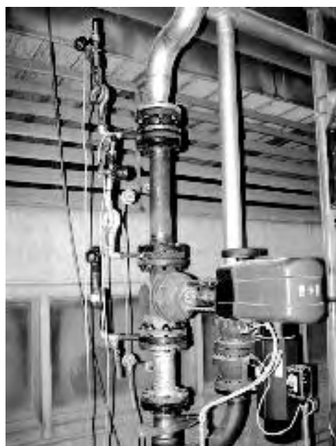
Bild 1: Dampfventil ARI Typ 470 mit Motorantrieb Nennweite DN80 mit Ein- und Auslaufstrecke nach EN 60534 mit Drucksensoren
