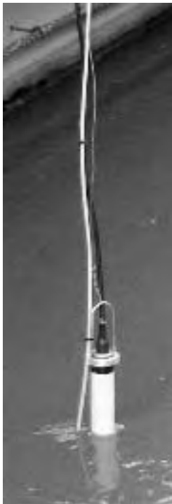
Abbildung 3: Spektrolyser im Belebungsbecken
