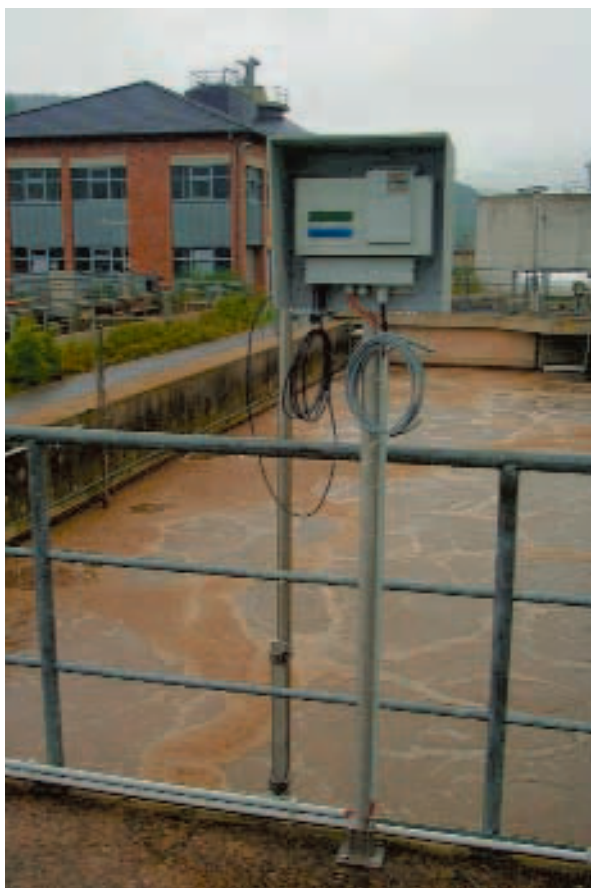
Bild 2: Belebungsbecken einer Kläranlage
