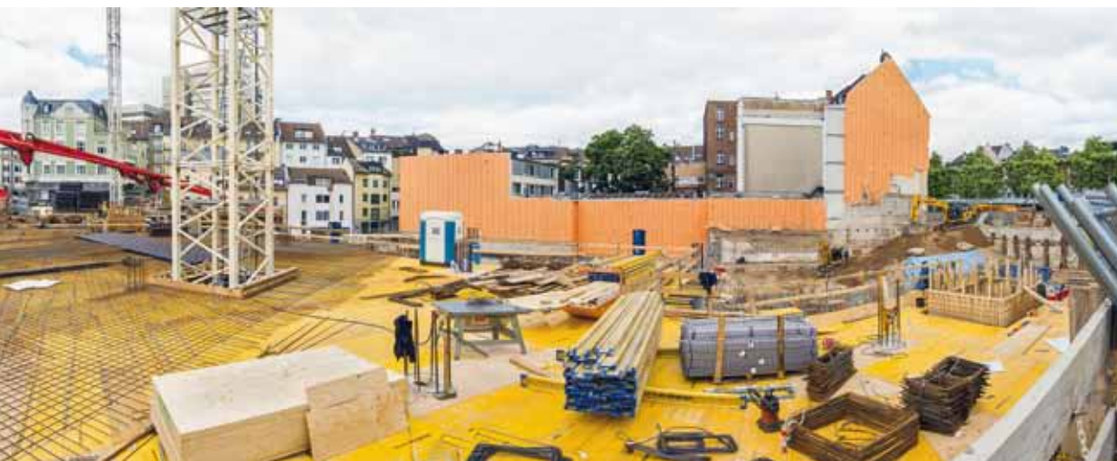
Seit der Grundsteinlegung im April 2012 sind die Arbeiten für den Neubau in vollem Gange.
