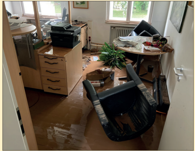
Zerstörungen der Innenräume im Hauptgebäude des Nationalparkforstamtes Eifel, in der Urtseestraße 34 in Schleiden-Gemünd.
