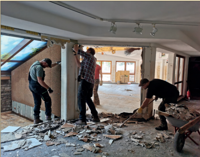
Mitarbeiter der Nationalparkverwaltung waren nach der Überflutung einige Tage vor Ort und haben unter anderem das Nationalpark-Tor ausgeräumt.
