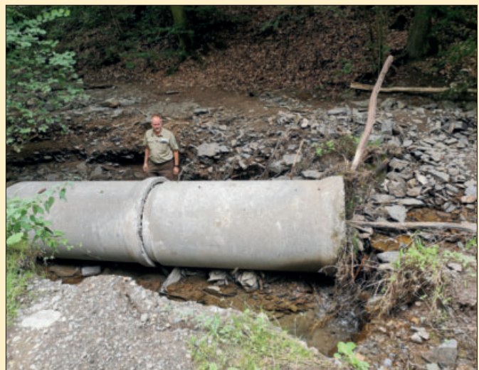
Besonders stark ausgespülter Weg: An der Querung des Laßbachs spülte die Wasserkraft das komplette Rohr frei. Normalerweise verläuft der Weg oberhalb des Rohres, das zuvor im Erdrich verborgen war. Hier wird die Chance genutzt und der Bachlauf in seinem natürlichen Bachlauf gelassen, nachdem das Rohr entfernt wurde.
