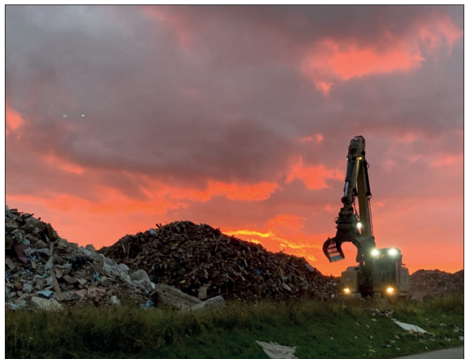
Die Aufräumarbeiten nach der Flutkatastrophe am 14. Juli führten zu gigantischen Müllbergen am Internationalen Platz Vogelsang.
