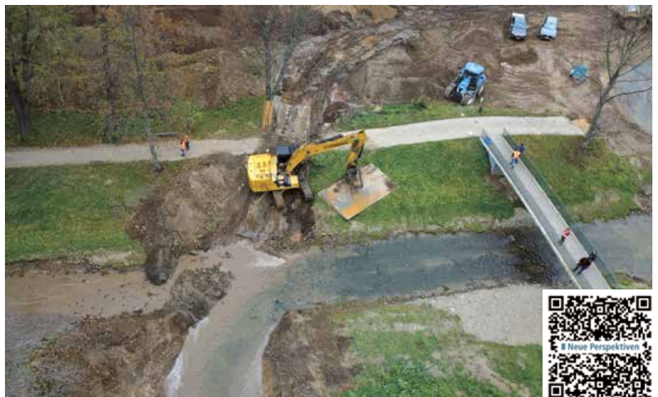
oben: Eine freigespülte Hochdruckgasleitung wird gesichert; unten: Die Erft »bezieht« ihr neues Bett.
