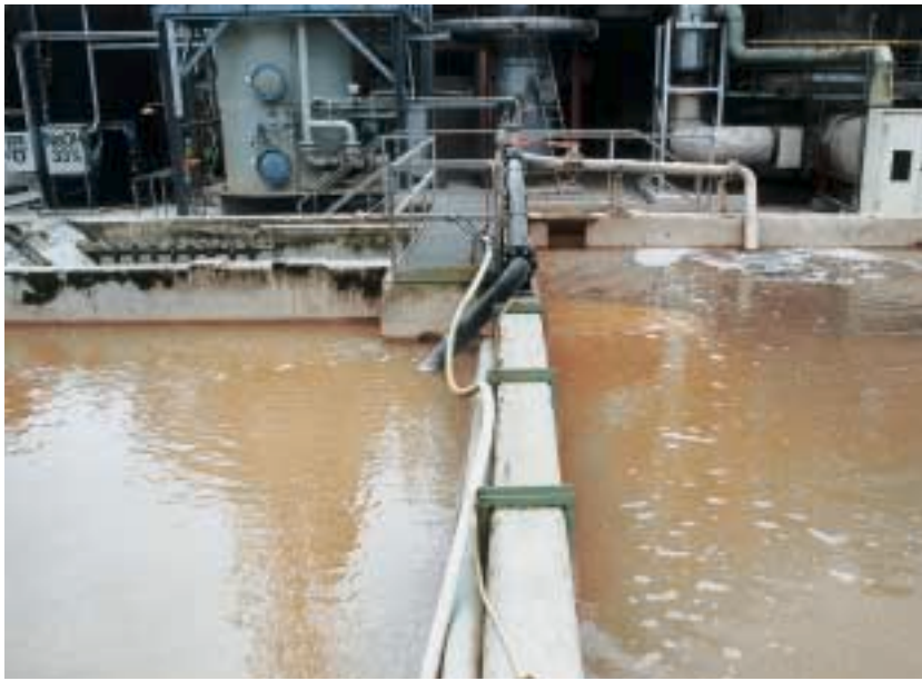
Abb. 2: Klärschlammverbrennung Düren: Absetzbecken zur Sedimentation der Abwässer aus der Rauchgaswäsche
