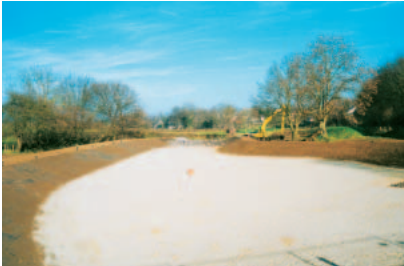
Bodenfilter (noch ohne Bepflanzung)
