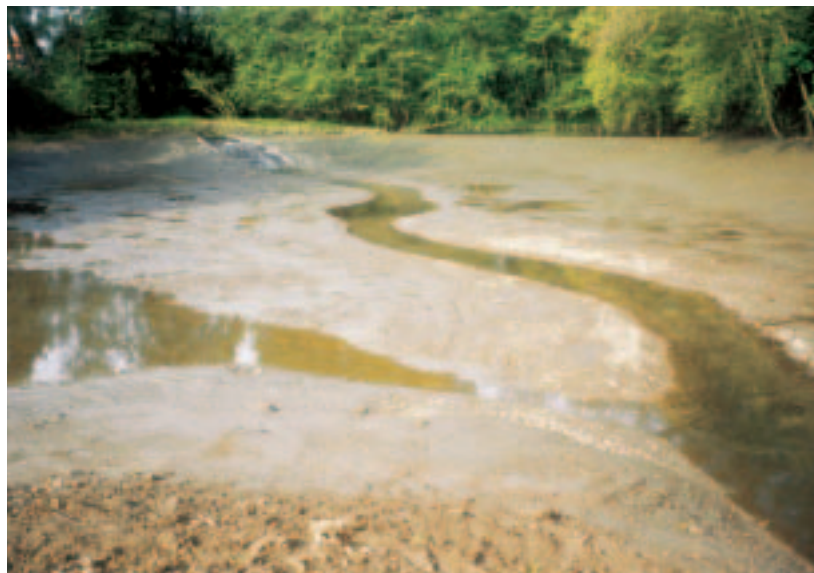
Das HRB Kinzweiler nach Abschluss der Erdarbeiten mit Sicht auf den angrenzenden Erlenbruchwald und eingepasster Sohlleite und drei Monate später nach der Eingrünung.
