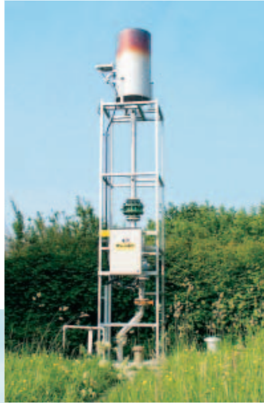
Gasfackel auf der Kläranlage Eschweiler
