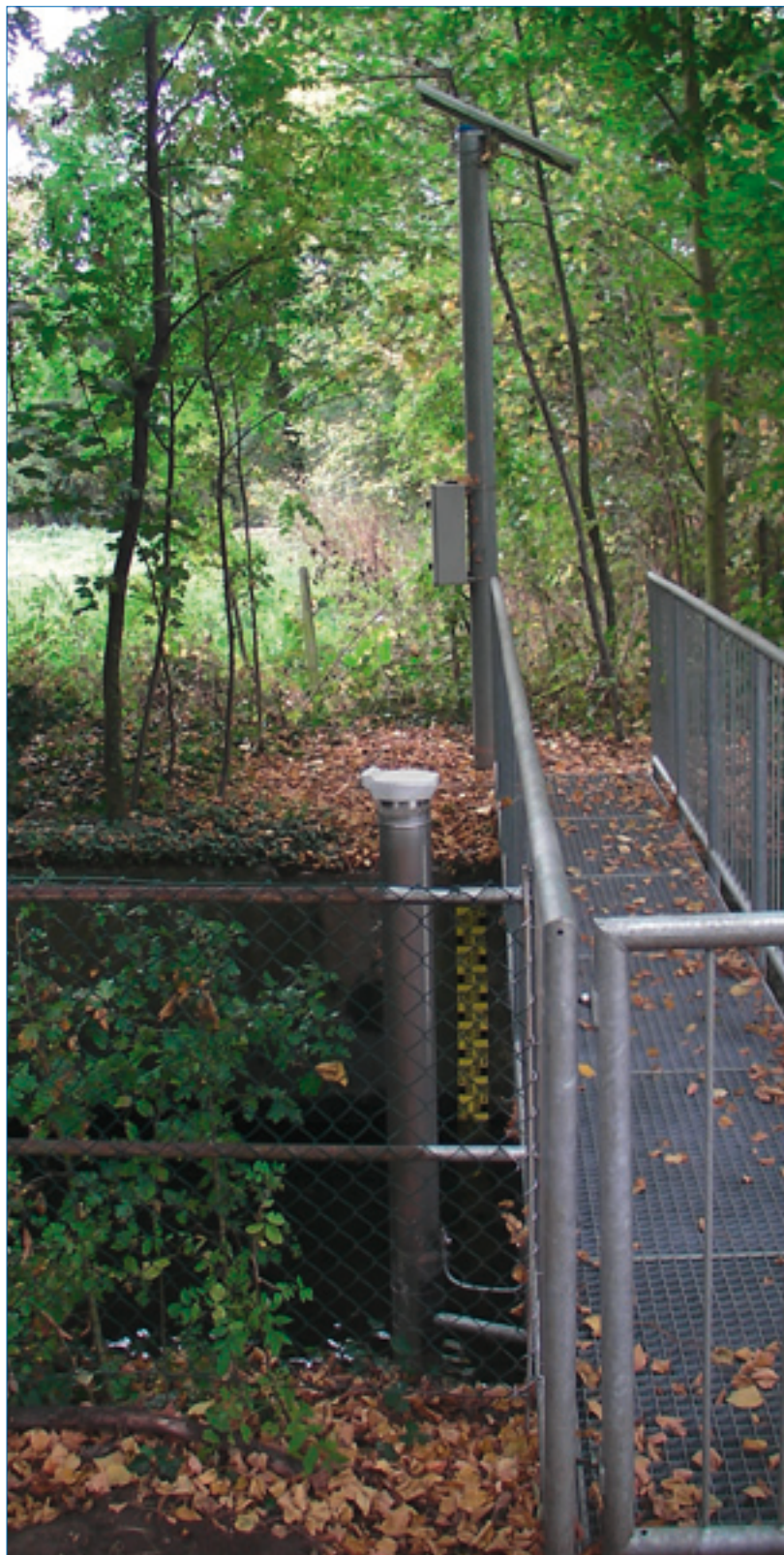
Neuer Pegel in Schneidhausen (Gemeinde Kreuzau) am Lendersdorfer Mühlenteich mit Solarstromversorgung
