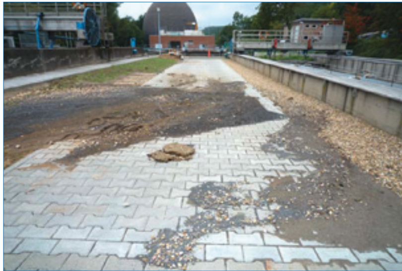
Ablagerungen nach Überflutung im Zulaufbereich der KA-Eilendorf
