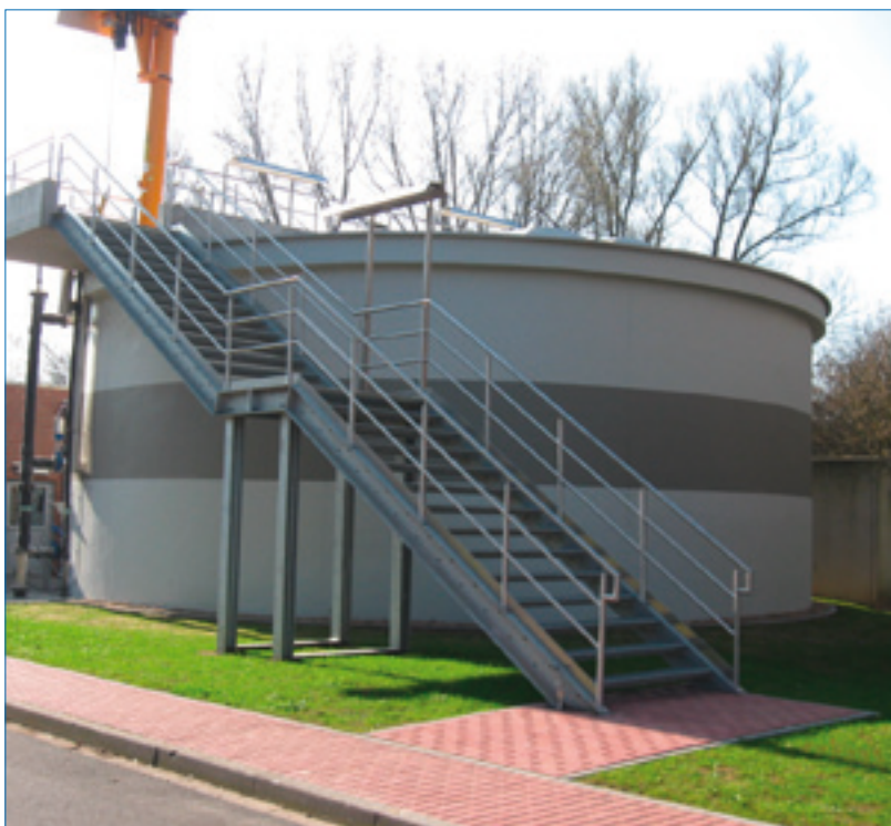
Faulgasbehälter auf der Kläranlage Eilendorf
