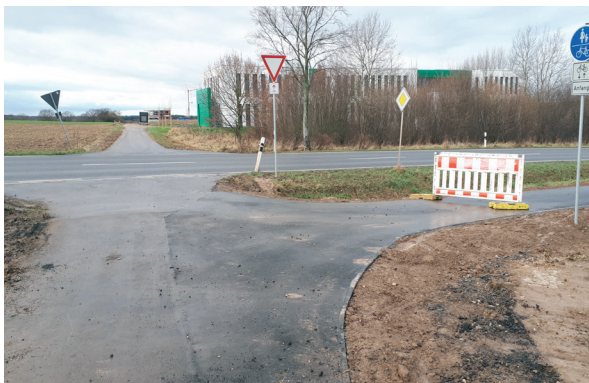
Achtung: Gefährliche Querung über den Wachtbergring
