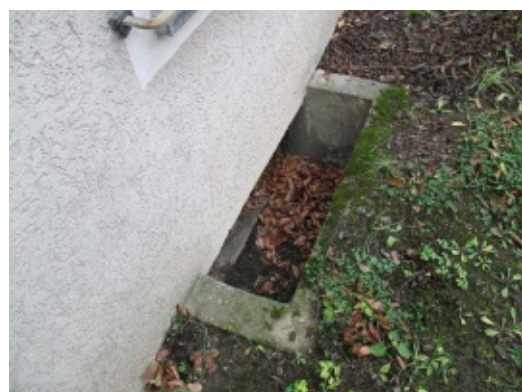
Vorher: Lichtschacht ungeschützt - Stolpergefahr
