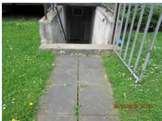
Vorher: Gefährliche Stolperkante in den Kellerabgang
