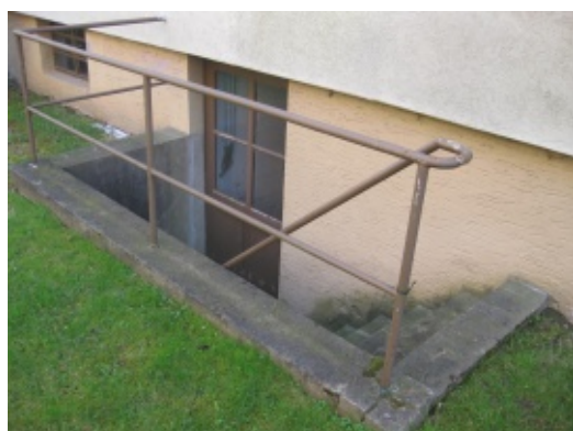
Vorher: An den zu großen Zwischenabständen des Geländers können spielende Kinder in den Kellerabgang abstürzen.
