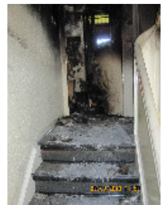
Verrustetes Treppenhaus nach Brand
