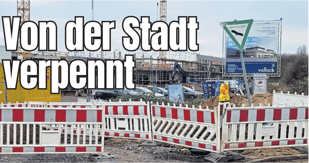
Darf an dieser Stelle eigentlich überhaupt gebaut werden? Aus der Baustelle ragt sichtbar das grün-weiße Schild für Landschaftsschutz hervor.
