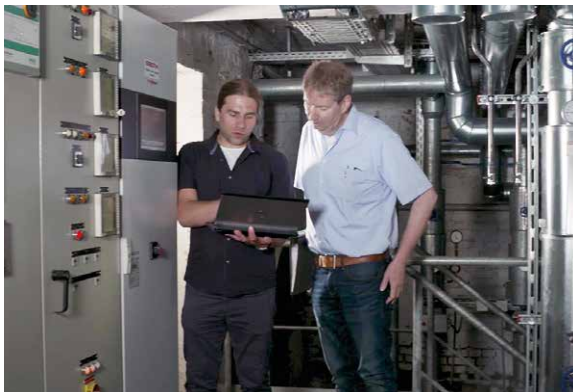
Die moderne Heizzentrale...
