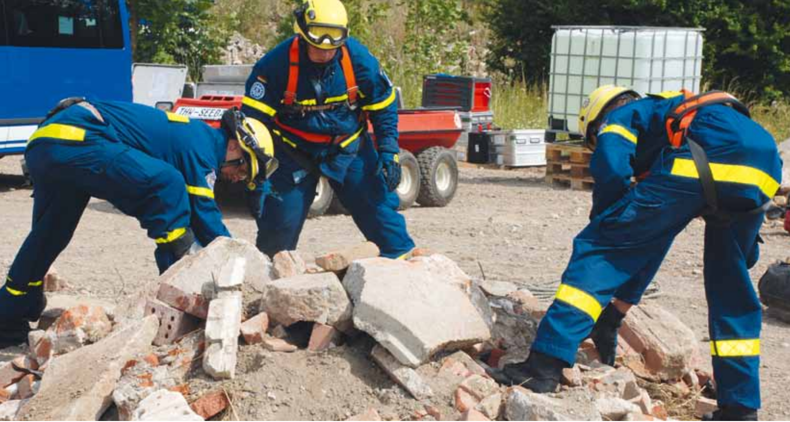
Unter Trümmern suchen THW-Helfer nach Verschütteten.
