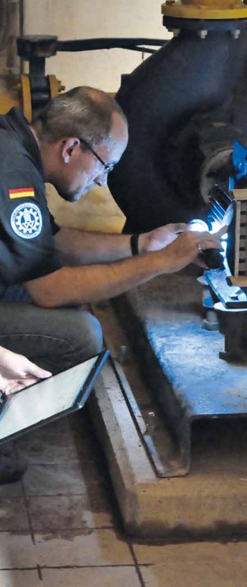
Ein THW-Fachberater überprüft die Einrichtungen der Wasser- und Stromversorgung in Burkina Faso.
