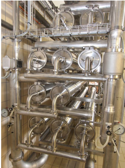
Anlage zur Ultrafiltration
