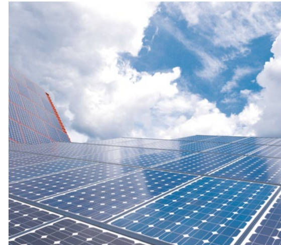
Die GIZ nutzt unter anderem die Photovoltaiktechnik zur umweltfreundlichen Gewinnung von Strom und Warmwasser.
