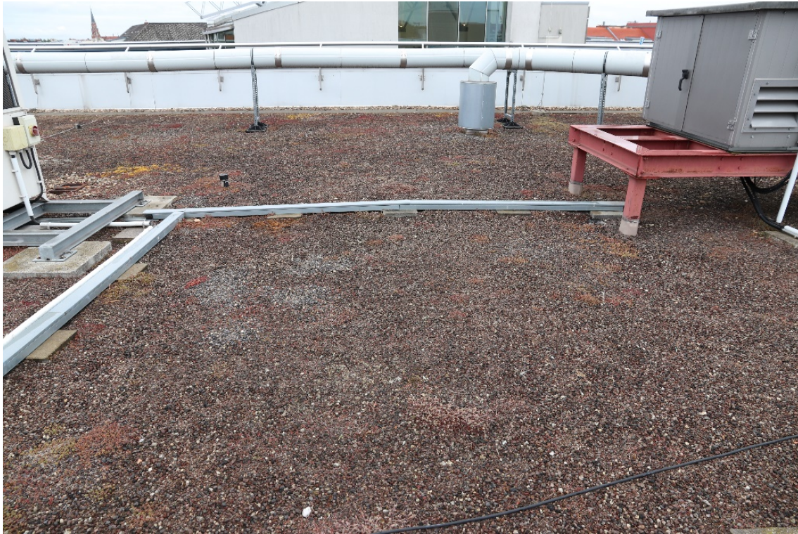
Abbildung 45 Dachbegrünung mit sehr geringer Vegetation aufgrund fehlender Pflege, hier muss eine flächendeckende Nachsaat/Ausbringung von Sedumsprossen erfolgen. (© Susanne Herfort)
