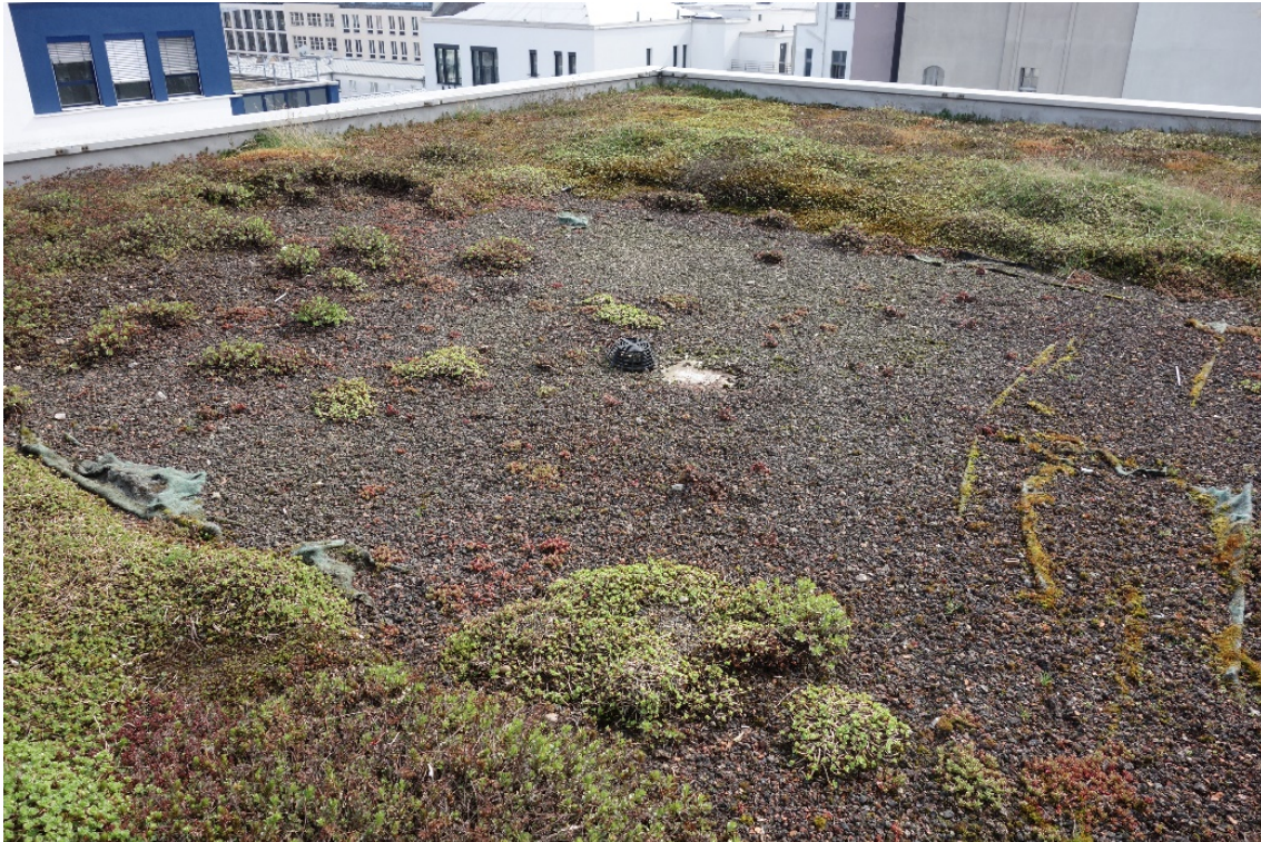
Abbildung 43 Bei Substratverwehungen und Freilegung des Schutzvlieses muss dringend wieder eine Substratschicht und Vegetation aufgebracht werden. (© Susanne Herfort)
