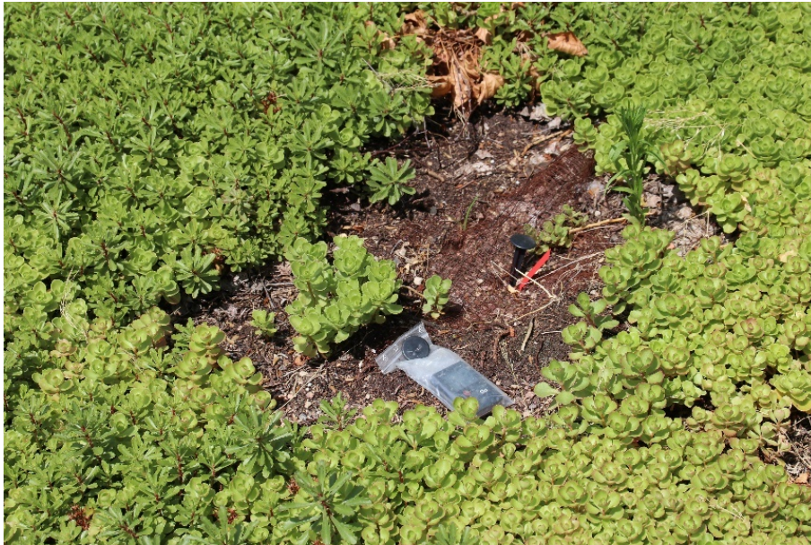
Abbildung 24 Untersuchte Fehlstelle auf einer extensiven Dachbegrünung bezüglich des Temperaturverlaufs (© Susanne Herfort)
