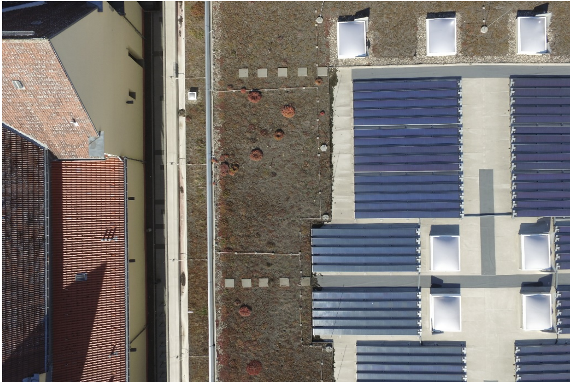
Abbildung 66 Draufsicht einer Dachbegrünung mit starken Fehlstellen in der Vegetation (© Benjamin Herfort)
