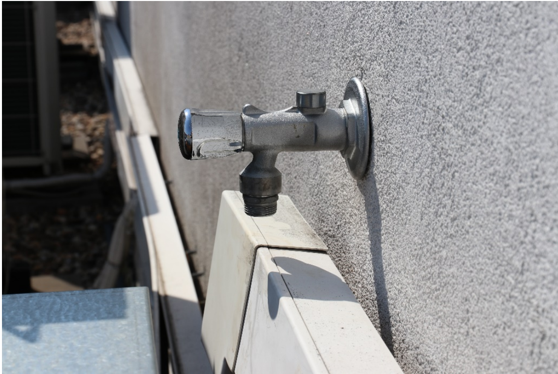
Abbildung 51 Vorhandener Wasserhahn nachträglich unterbaut und dadurch nicht mehr nutzbar, der durch einen Wasserinstallateur wieder funktionsfähig gemacht werden kann. (© Susanne Herfort)
