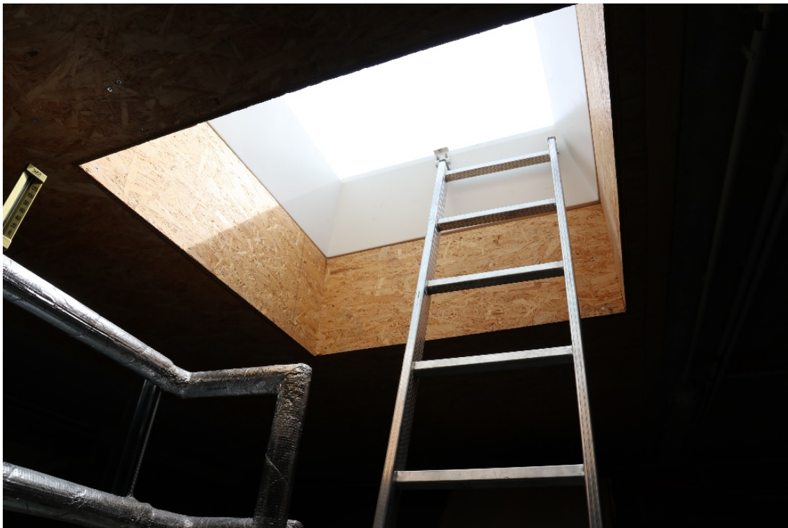
Abbildung 52 Ungesicherte Leiter, bei der nachträglich Haken an der Leiter und am Dachausstieg befestigt werden müssen. (© Susanne Herfort)
