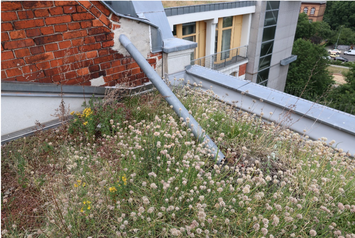
Abbildung 49 Falsche Dachentwässerung auf Dachbegrünung, die von einer Firma korrigiert werden muss. (© Susanne Herfort)
