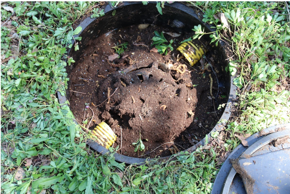
Abbildung 48 Ungereinigter Abwasserschacht, der mit einer kleinen Schippe gereinigt werden kann. Im Anschluss sollte der Schacht mit Wasser gespült werden. (© Susanne Herfort)
