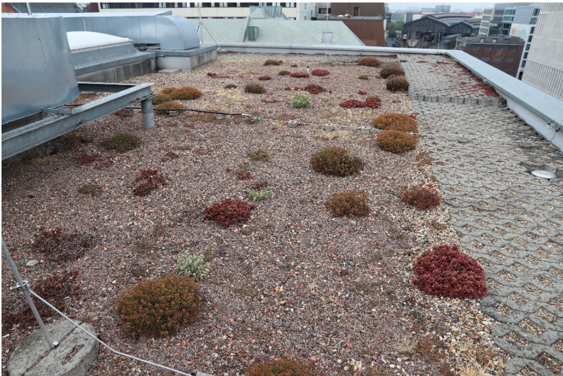
Abbildung 44 Lückenhafte Vegetation aufgrund fehlender Düngung und Bewässerung, hier kann mit Sedumsprossen von der gleichen Dachfläche die Pflanzendeckung erhöht werden. (© Susanne Herfort)
