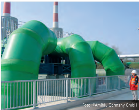
Kühlwasserleitung aus GFK in einem Gaskraftwerk
