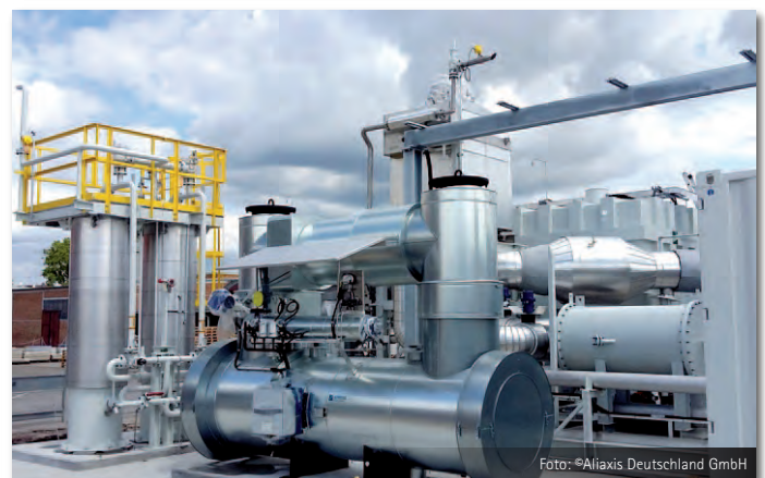
1,4 Megawatt Brennstoffzelle (MCFC) zur Energieversorgung des Produktionsstandorts
