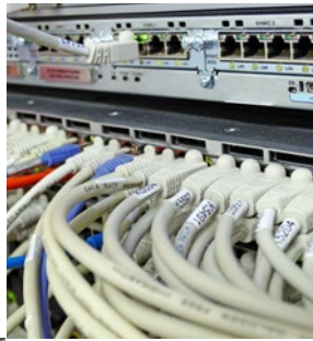
← Telefonie per Voice-over-IP: Drei Netzwerk-Switches mit je 48 Anschlüssen verteilen die Leitungen in die Büros der Außenstelle.
