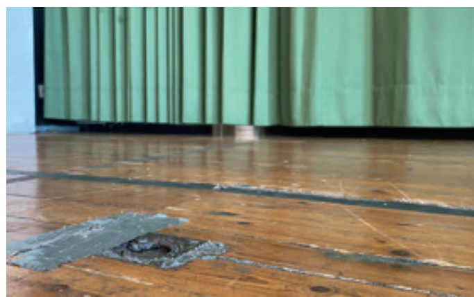
Der Boden der Bühne muss dringend erneuert werden.
