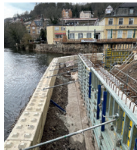
Derzeit werden die Stahlbetonstützwände eingeschalt, betoniert und anschließend mit Bruchstein verblendet. (© Gudrun Klinkhammer / www.gkli.de)
