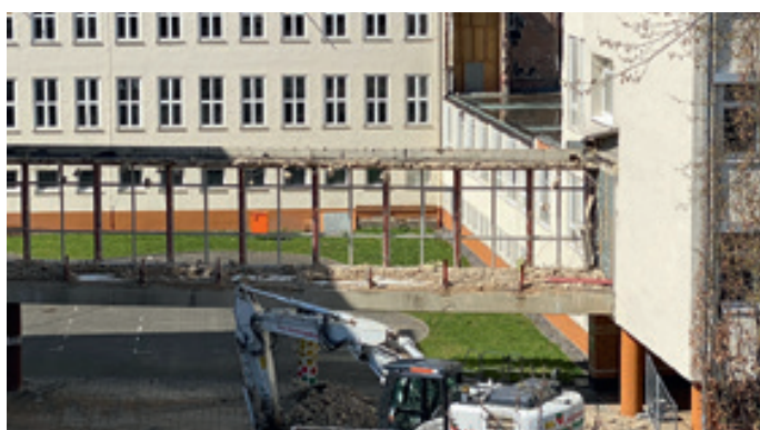
Bis zum 16. April soll der Verbindungsgang zwischen den Gebäudeteilen A und B am Johannes-Sturmius-Gymnasium abgerissen sein. (© Stadt Schleiden/Kerstin Wielspütz)
