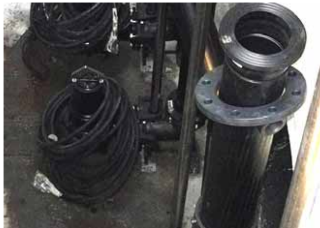
Neue Tauchmotorpumpen, mit PEHD Rohrmaterial in der Bauphase
