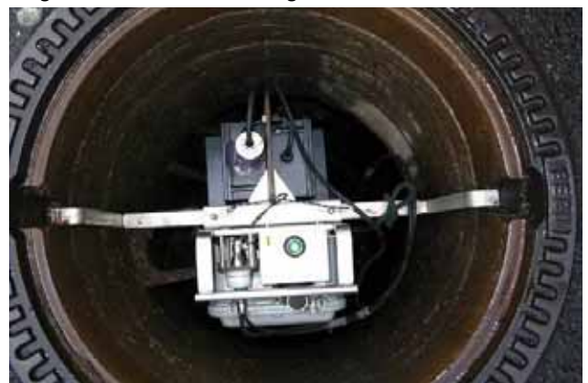
Eingebautes Probenahmegeräte im Kanalschacht
