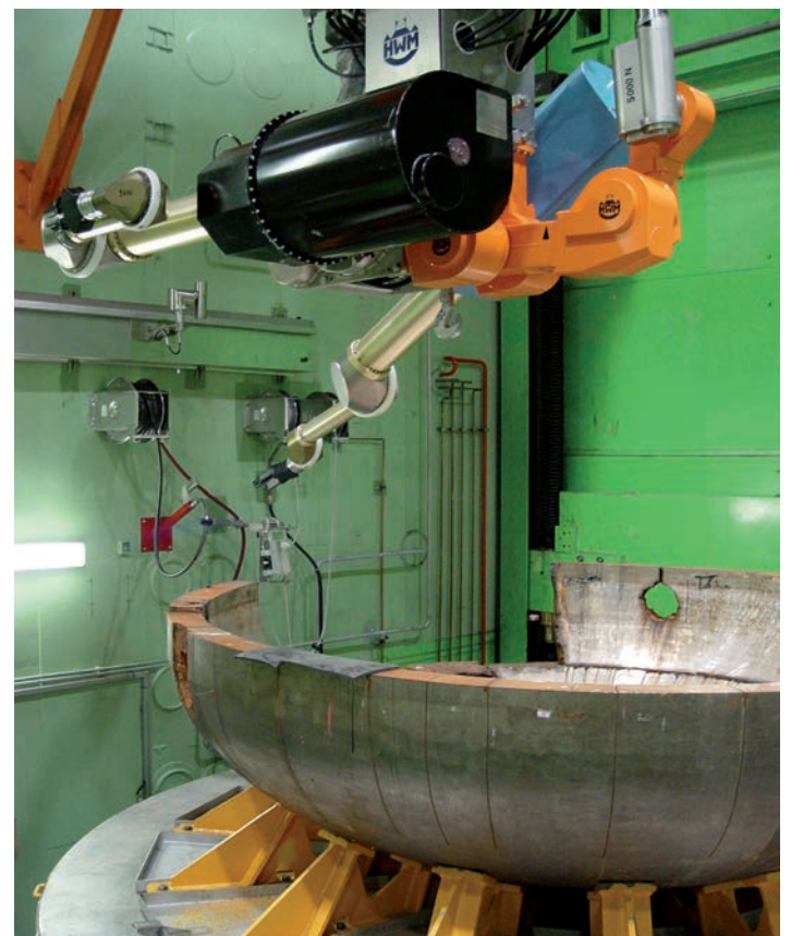
Abb. 29b: Kammer zur Trockenzerlegung
