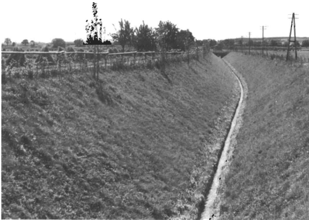
Naturwidrig angelegter Wasserlauf, was seine Führung, Böschungsbildung und Bepflanzung betrifft. (Foto: Olschowy)
