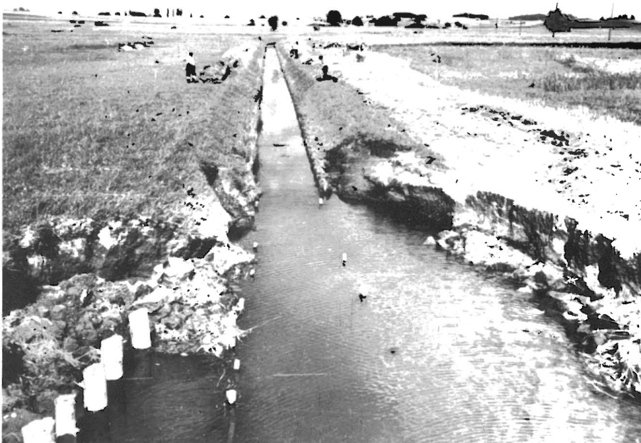
Hinter Brückendurchlässen, die zu eng bemessen sind, treten bei Hochwasser häufig Kolksschäden an beiden Ufern auf.
