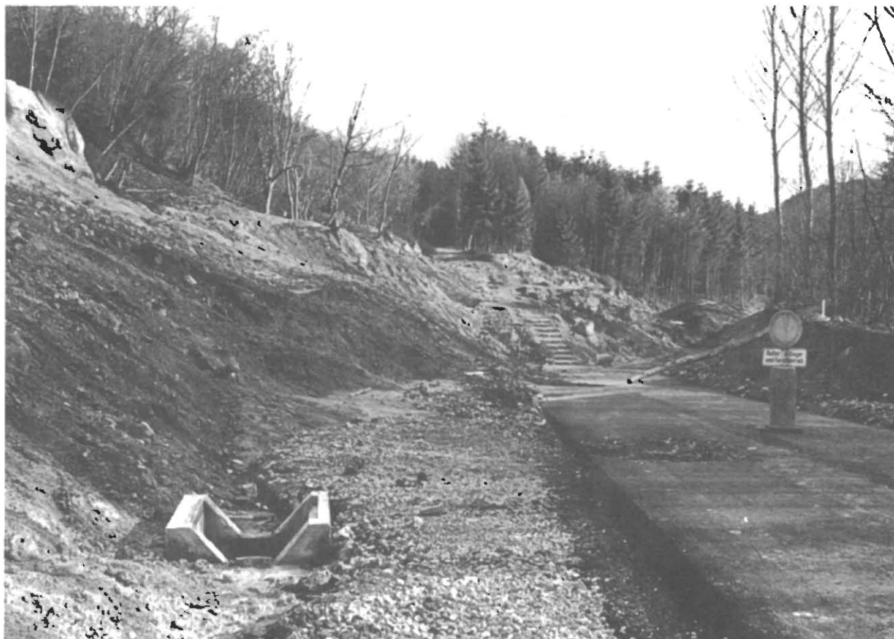
Hangrutsch im Bereich der Neubastrecke der Kreisstraße (K 19) zwischen Ferschweiler und Wellerbach unterhalb des Ferschweiler Plateaus im Jahr 1977, ein Jahr nach dem Ereignis. Foto: W. Pflug
