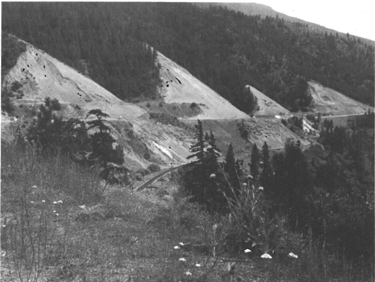
Eine in den Hang gelegte Verkehrsstraße hat eine Reihe von Hanganschnitten erforderlich gemacht, die mit Maßnahmen des Lebendverbaus stabilisiert werden müssen.
