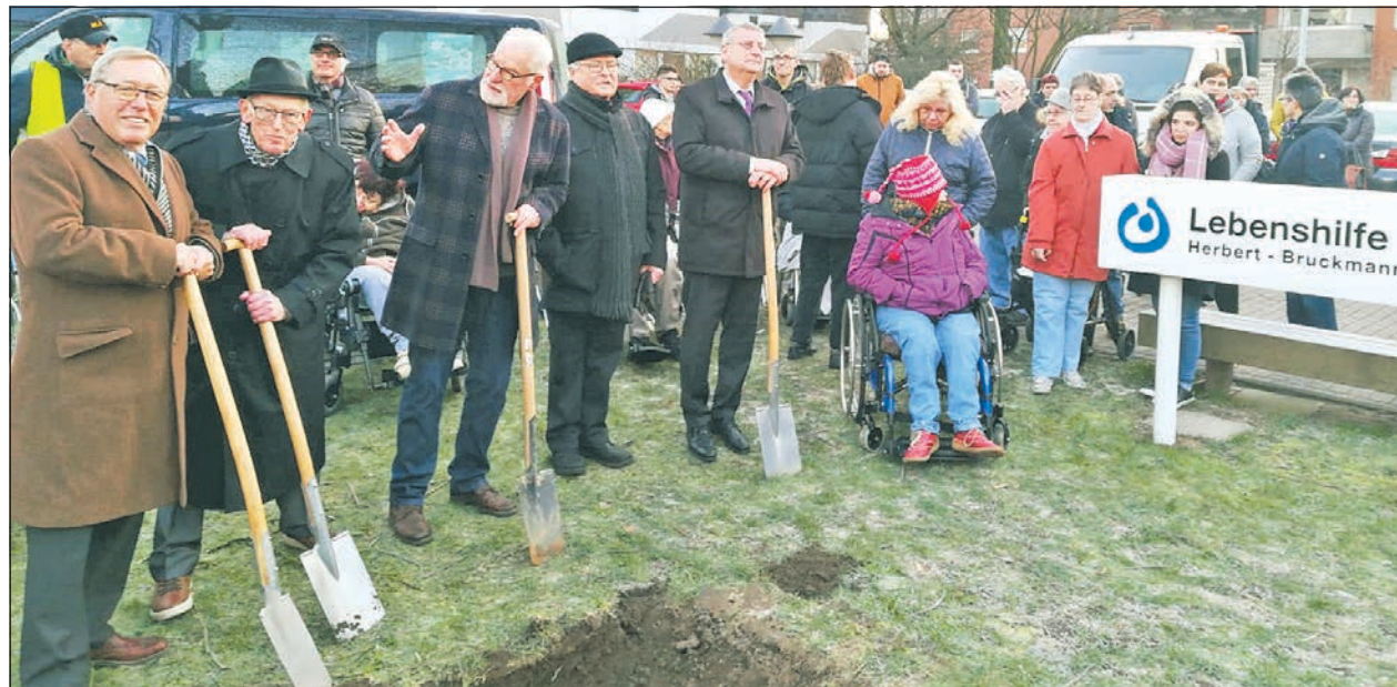
Unser Bild zeigt den Ehrenvorsitzenden Egon Berchter (2. v. links) und den Lebenshilfe-Vorsitzenden Jürgen Fischer (links) sowie den Architekten Hans Gerd Mölleken (3. v. links) mit viel Publikum beim ersten Arbeiten an der Baugrube. Fotos (3): Lebenshilfe Oberhausen
