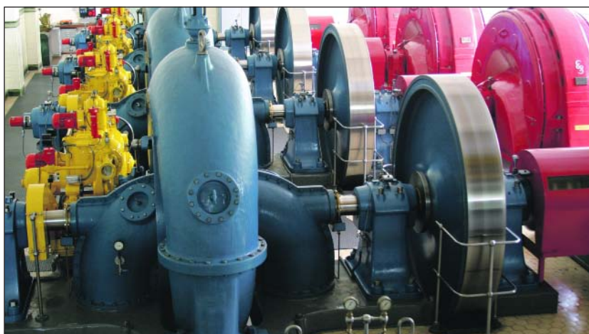
Maschinenraum Wasserkraftwerk Andelsbuch, Österreich. Foto: Mainzer
