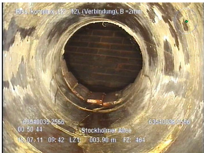
Schaden vor Kurzlinereinbau
