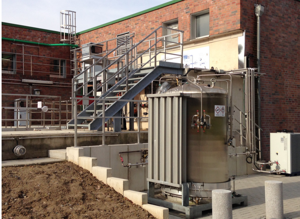
Großtechnische Pilotanlage im Klärwerk Köln-Rodenkirchen
