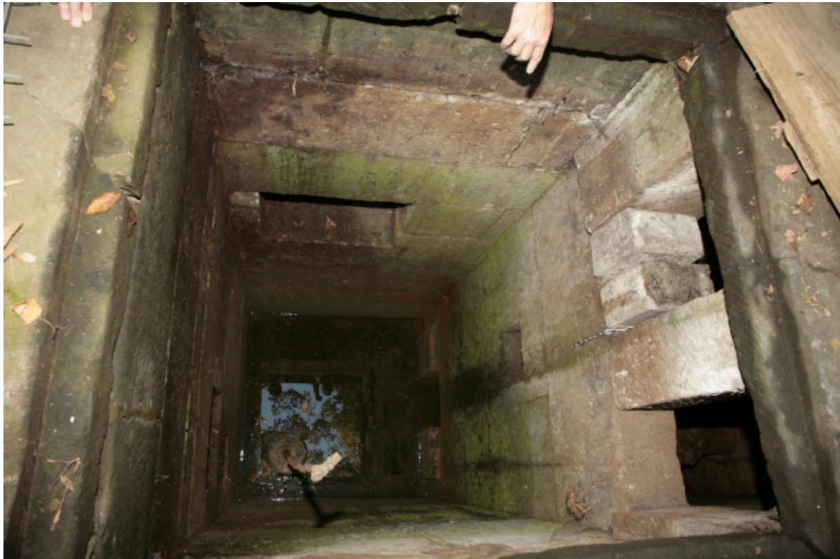
Siebschacht S1 mit Bodenentleerung des Hochplauenschen Wasserhauses
