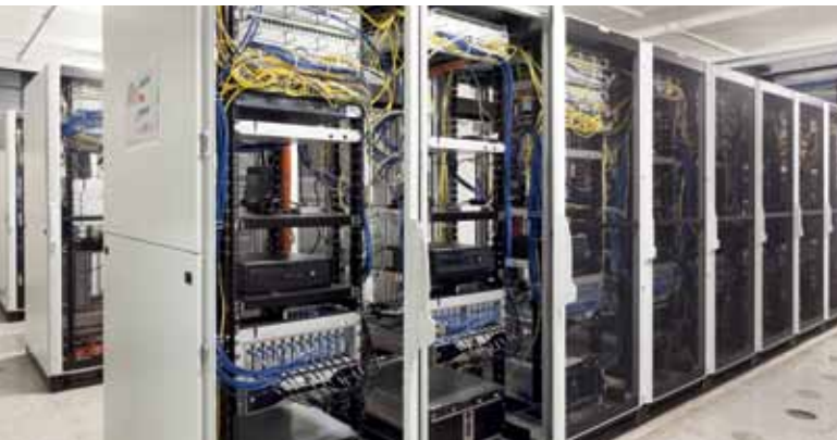
Im Untergeschoss des Leitstellengebäudes befinden sich die Rechner für die Arbeitsplatzmonitore.
