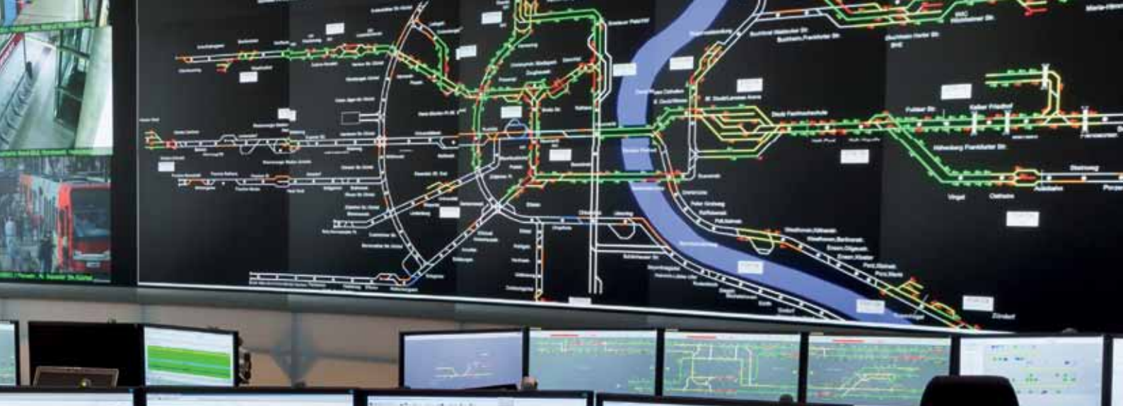
Die Videowand liefert dem Leitstellenteam immer den aktuellen Überblick über das Liniennetz (rechts), die Stromversorgung (links) und die Situation in den Haltestellen (Mitte).
