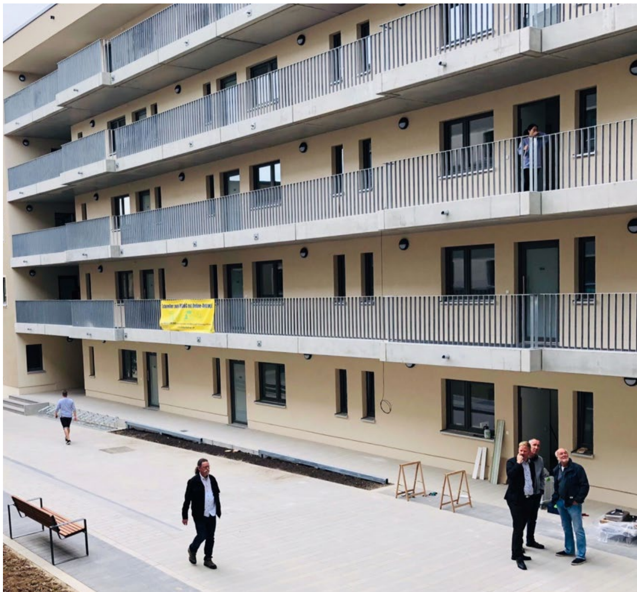
Variowohnungen-Projekt des Studierendenwerks Thüringens in Jena
