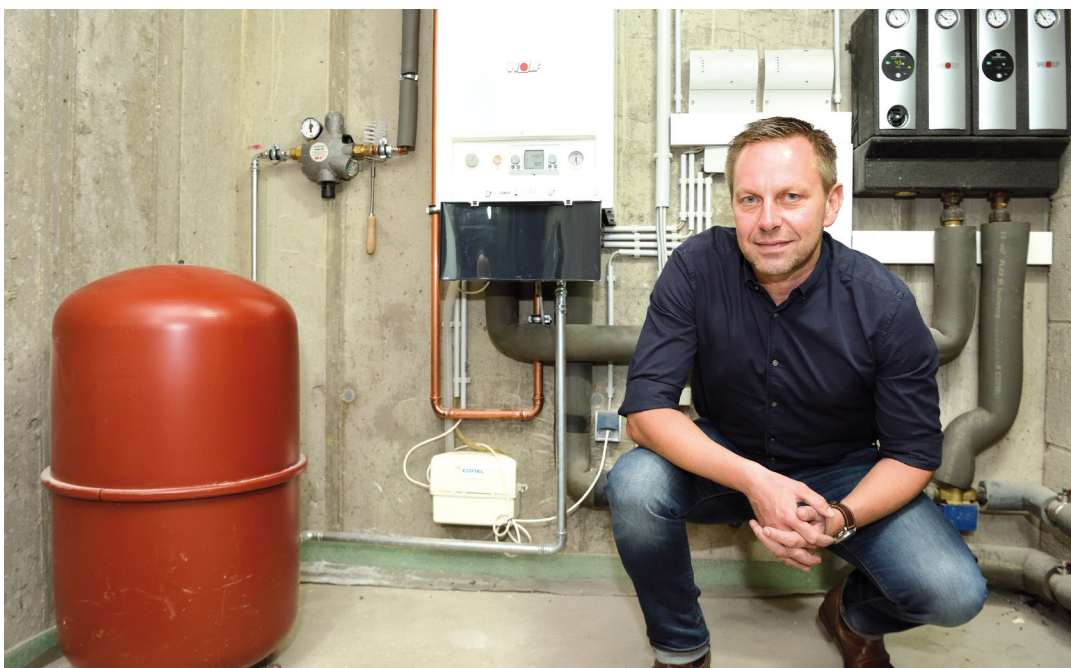
EWV-Heizungsexperte Elmar Höfer.
