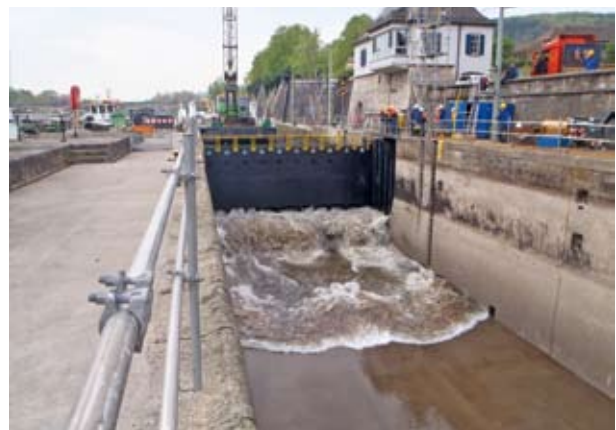
Eingebautes Oberhaupttor Schleuse Würzburg beim Fluten
