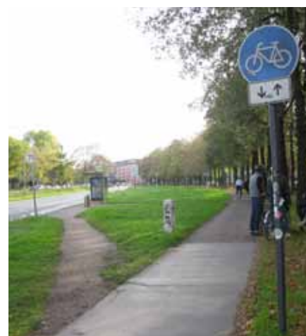
Der marode Fahrradweg an der Universitätsstraße zwischen Aachener Straße und Gottfried-Keller-Straße soll durch einen Neubau ersetzt werden.
