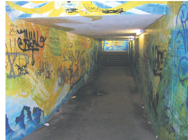
Bild 19: Unterführung Bahnhof Overath keine subjektive Sicherheit
