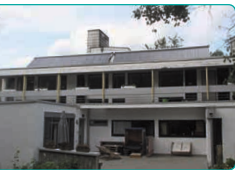
Thermische Solaranlage auf dem Dach des Hauptgebäudes
