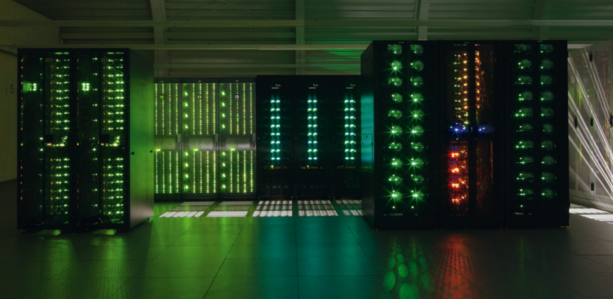
Hochleistungsrechner des IT Centers der RWTH Aachen University
