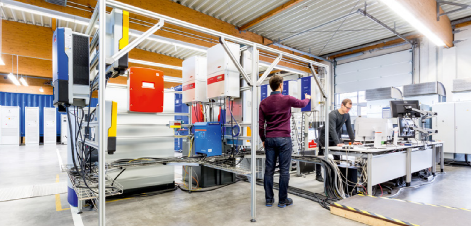
Abbildung 1: Teststand Niederspannungslabor des IFHT mit netzbildenden Batteriewechselrichtern
