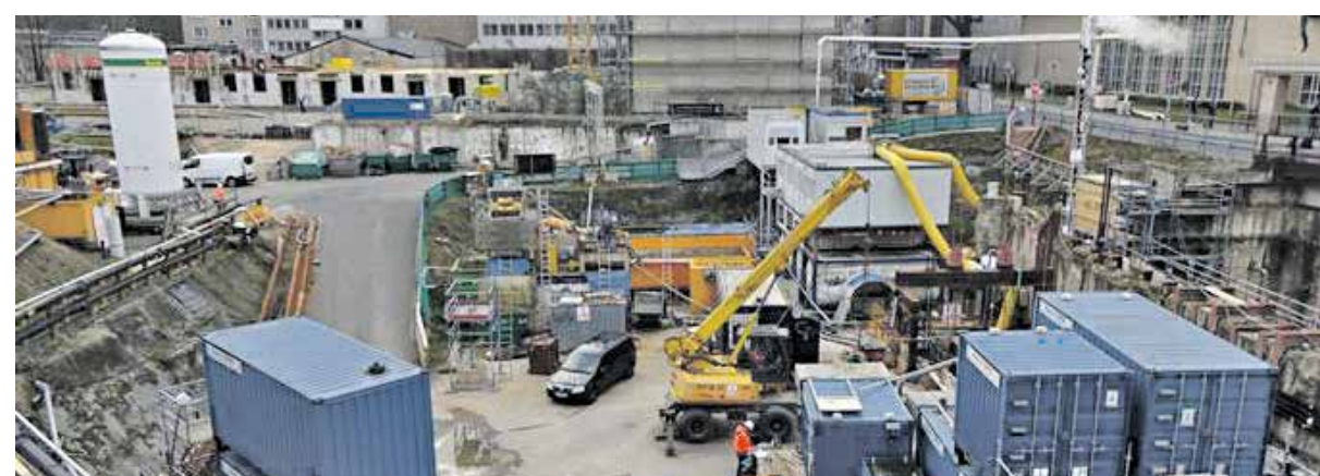
In der Baugrube am Waidmarkt gehen die Untersuchungen zur Unglücksursache noch geraume Zeit weiter
