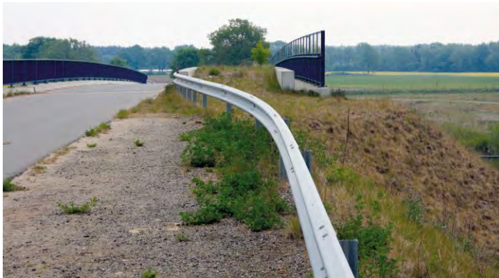
Abb. 48: Nutzung von Grünstreifenbau- werken (2)
