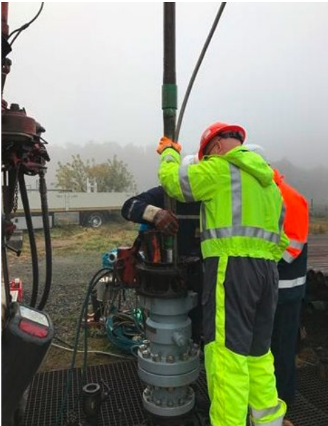
Abb. 11: Installation des MDA
