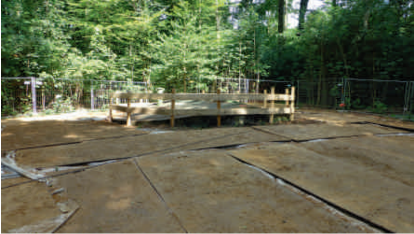
Bild 5.4: Absicherung eines Kesselbrunnens vor unbefugtem Zutritt und versehentlichem Absturz
