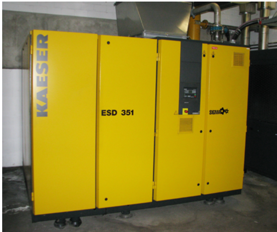
Kompressor mit Wärmereückgewinnung (WRG)
