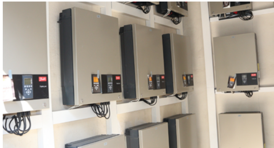
Wechselrichterraum der Photovoltaikanlage
